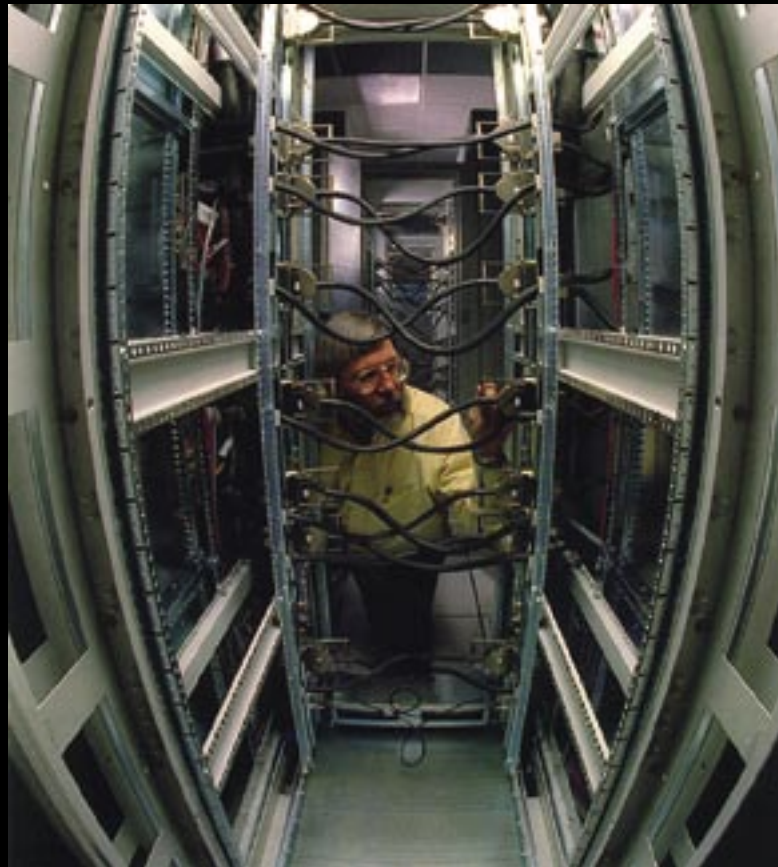
INTERCONNEXIONS entre deux armoires de « Asci Red », champion du monde 1997, réalisé par Intel pour les Sandia National Laboratories.
