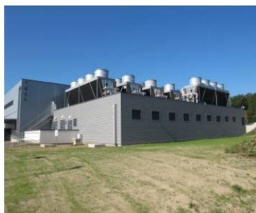
Tour de refroidissement hybride (air/eau)
